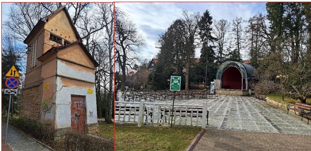
Rysunek 18. Stan techniczny wybranych obiektów zabytkowych w Parku Zdrojowym: budynek trafostacji i muszla koncertowa.
